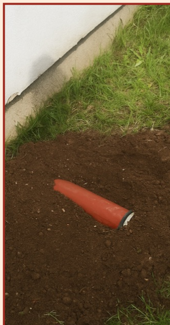
Røret skal frigraves, som på billedet, således at det er synligt i fuld bredde og fra siden.
